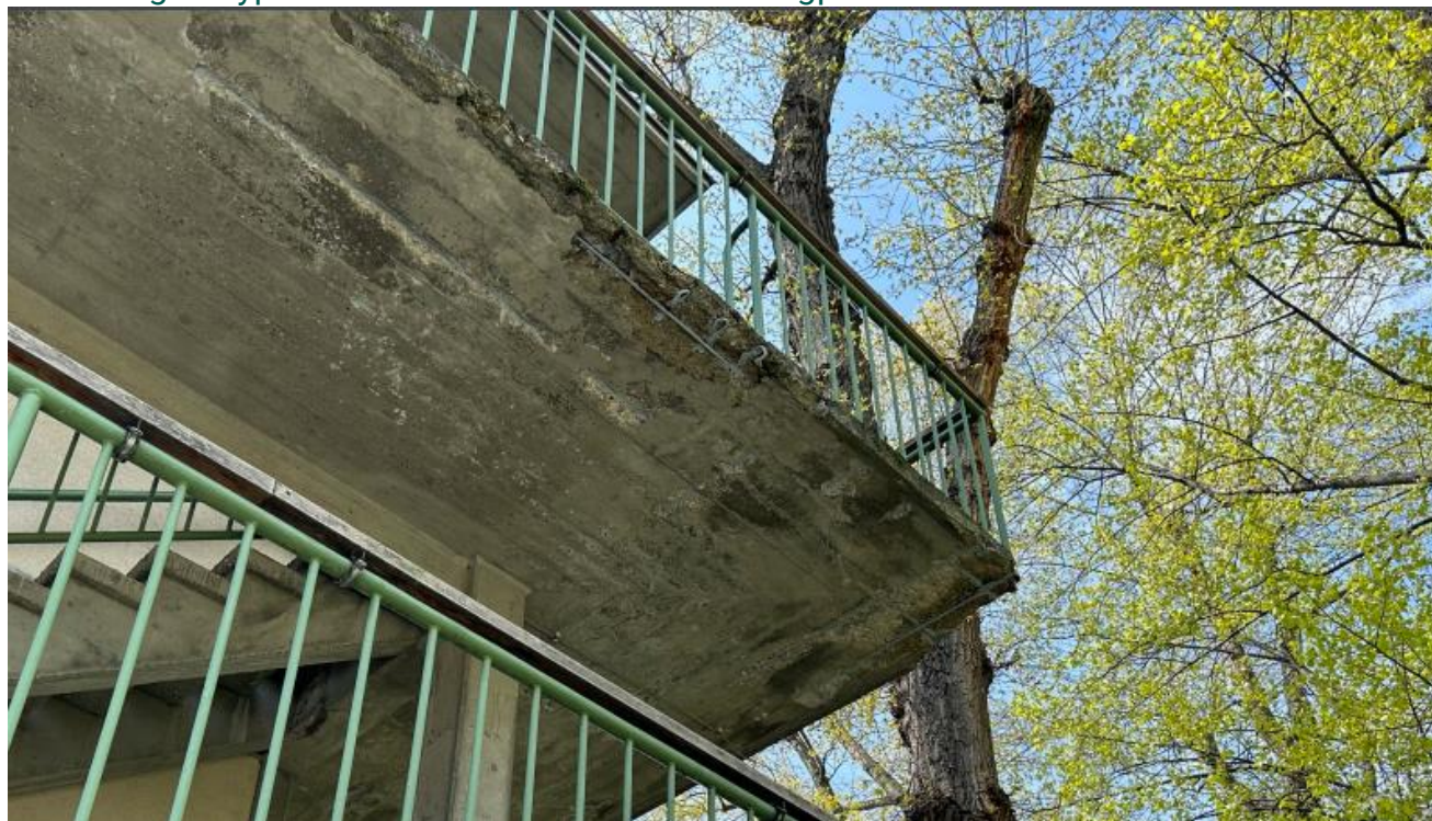
Abbildung 3: Typisches Schadensbild an einer Kragplatte
