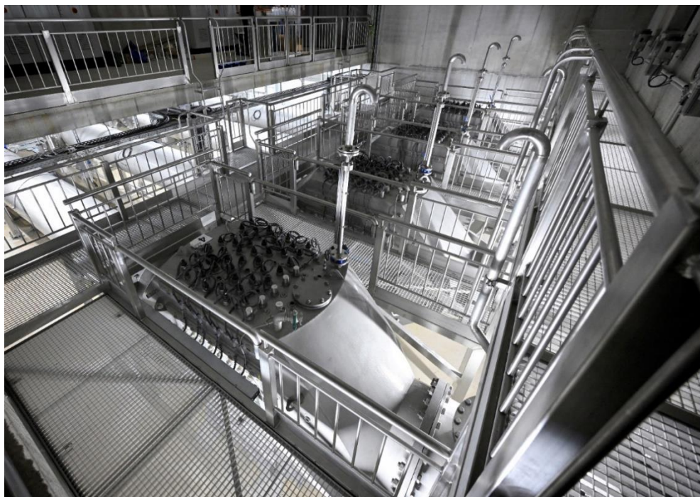
Abbildung 1: UV-Desinfektionsanlage Mauer bestehend aus 4 UV-Geräten
