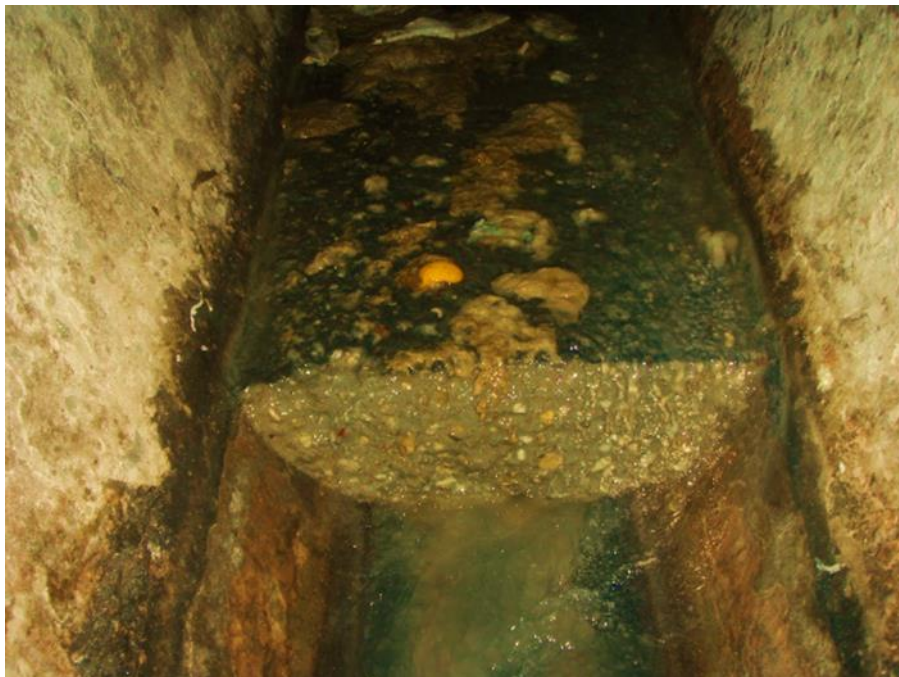
Abbildung 1: Betonablagerung im Kanal
