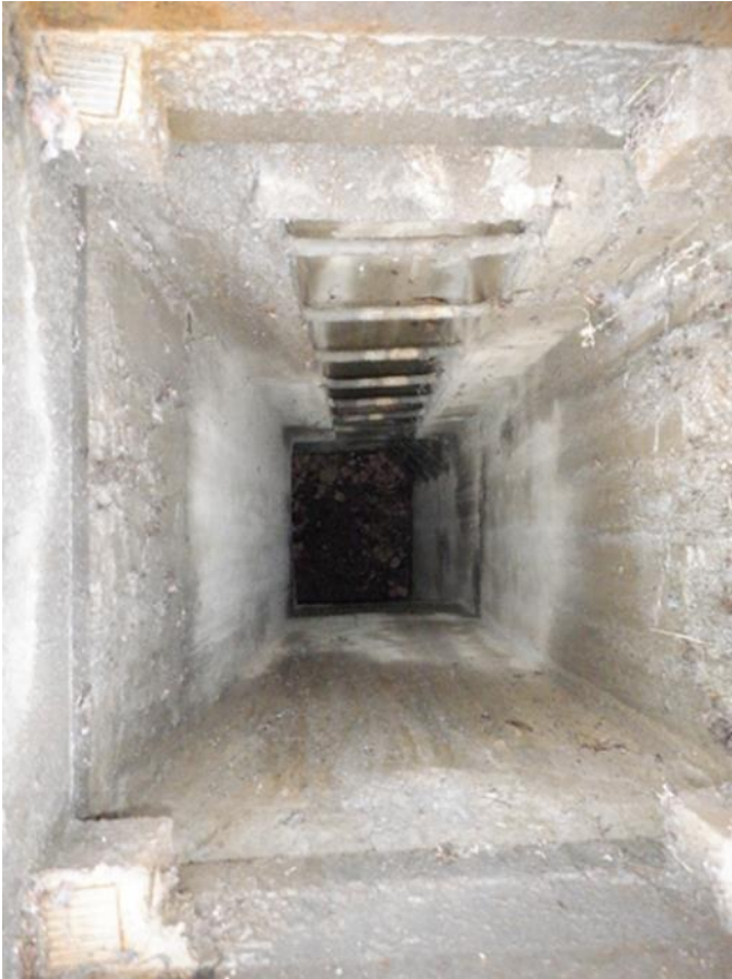
Abbildung 5: Steighilfen vor deren Erneuerung
