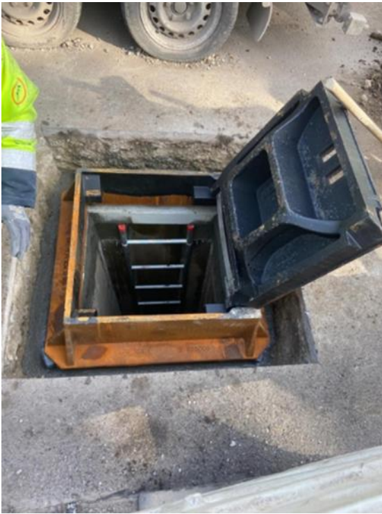
Abbildung 6: Neue Steighilfe (Leiter) und neuer Kanaldeckel
