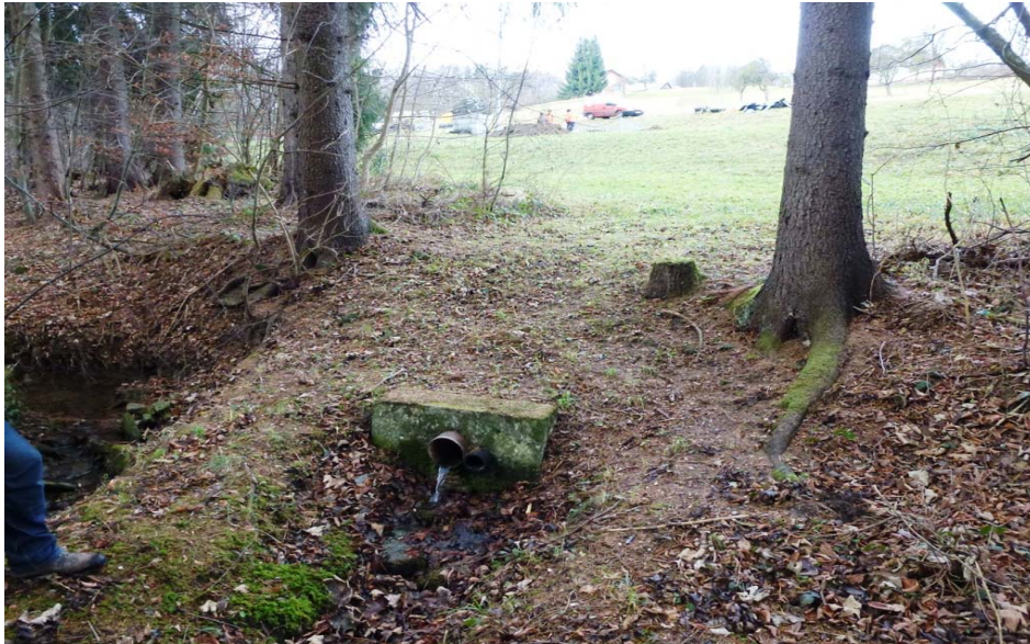
Abb.3: Ausmündung eines Drainagerohres
