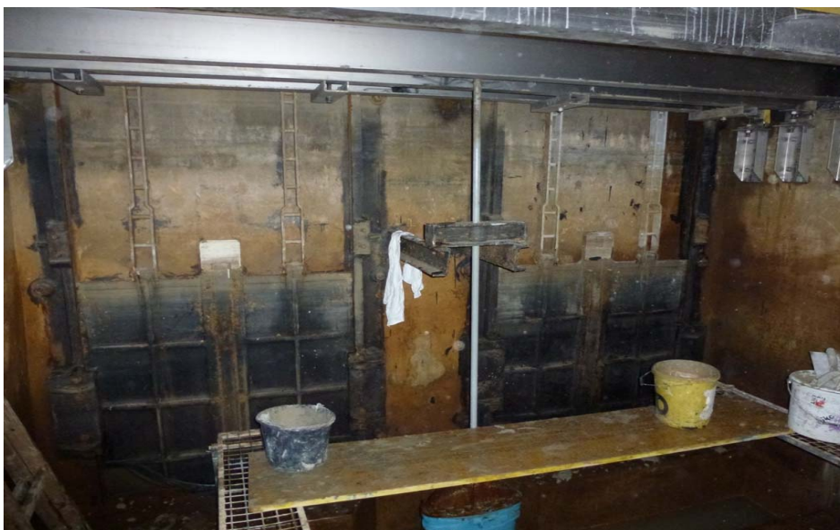
Abb. 7: Bühnen-träger und Absperrschütze zu den Dükerleitungen
