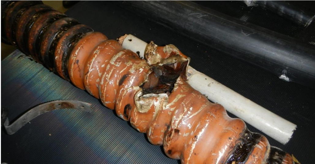
Abbildung 5: Hochspannungskabel, welches bei Grabungsarbeiten beschädigt wurde
