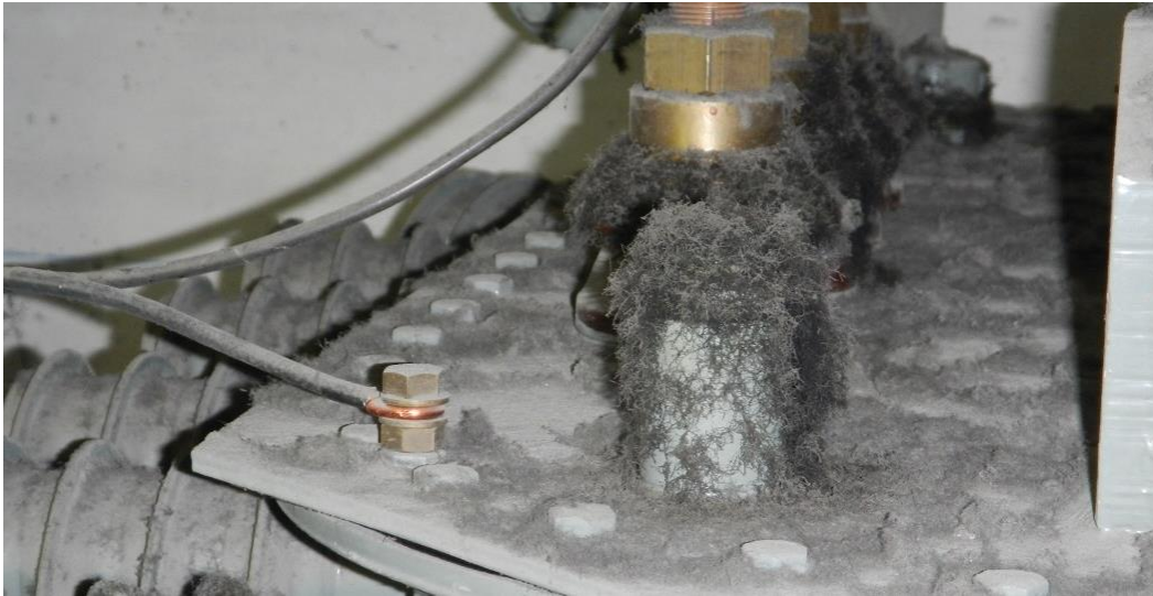
Abbildung 6: Dicke Staubschicht auf einem Transformator einer Transformatorstation
