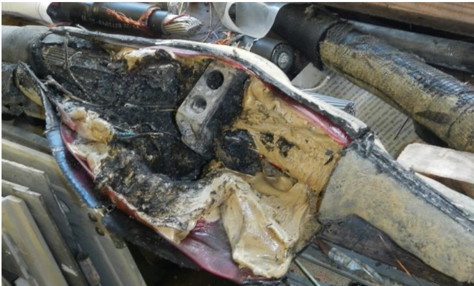
Abbildung 4: Zerstörte Stückelungsstelle einer nicht ordnungsgemäßen Kabelverbindung
