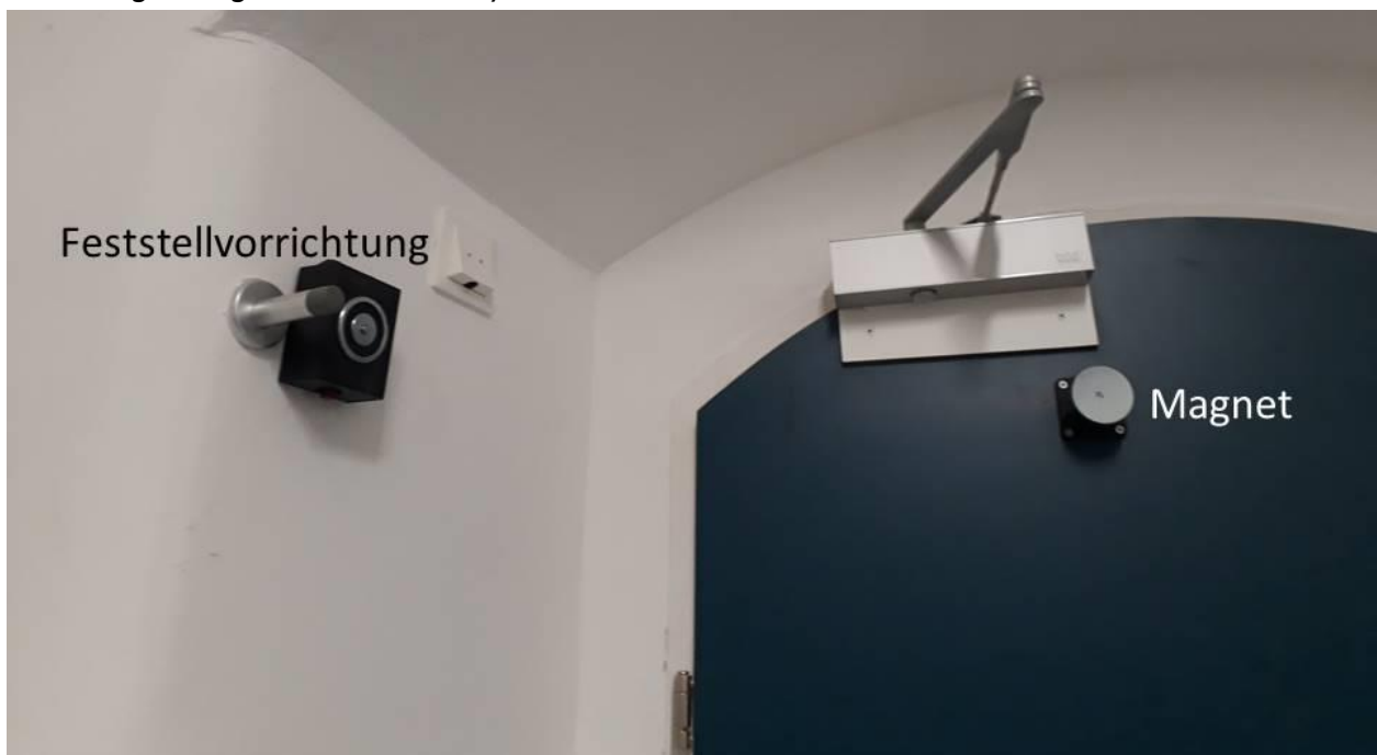
Abbildung 5: Magnetisches Schließsystem einer Brandschutztür
