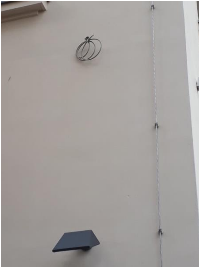
Abbildung 4: Kabel ragen aus der Außenwand des Altbaus
