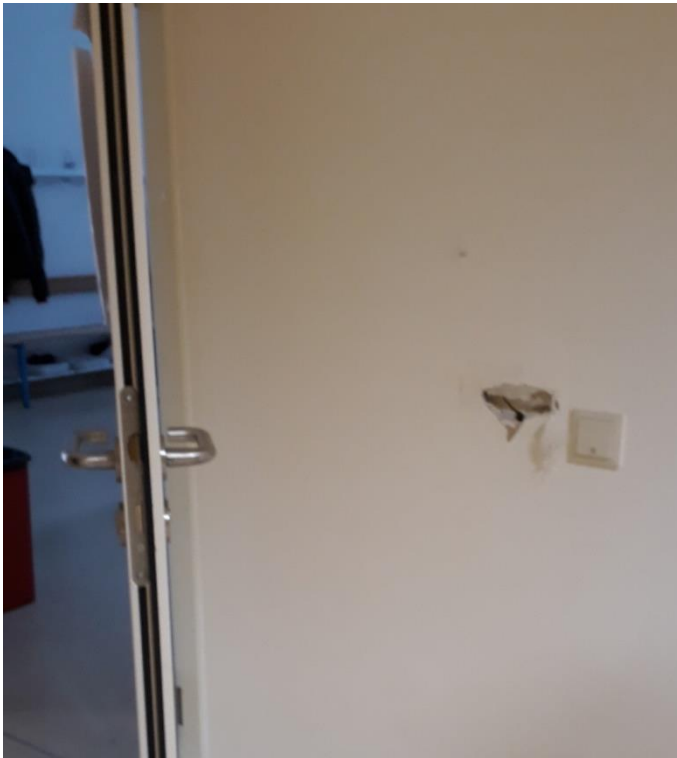
Abbildung 2: Loch in der Gipskartonwand, verursacht durch eine Türschnalle
