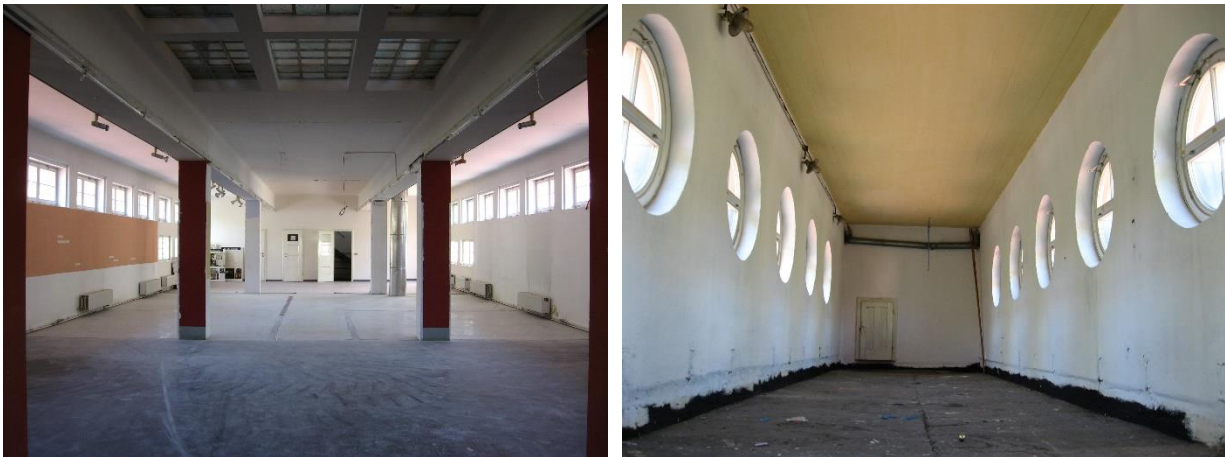
Abbildung 6: Zustand des Mietgegenstandes vor der Renovierung
