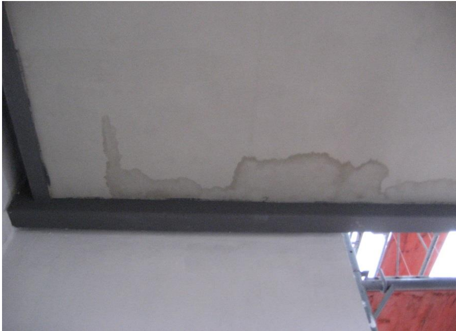
Abbildung 12: Nässeschäden an den neu hergestellten Balkonuntersichten
