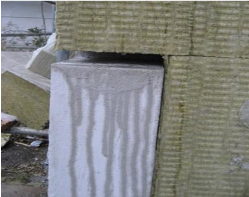
Abbildung 8: Mangelhafte Fugenausbildung im Fassaden-Eckbereich
