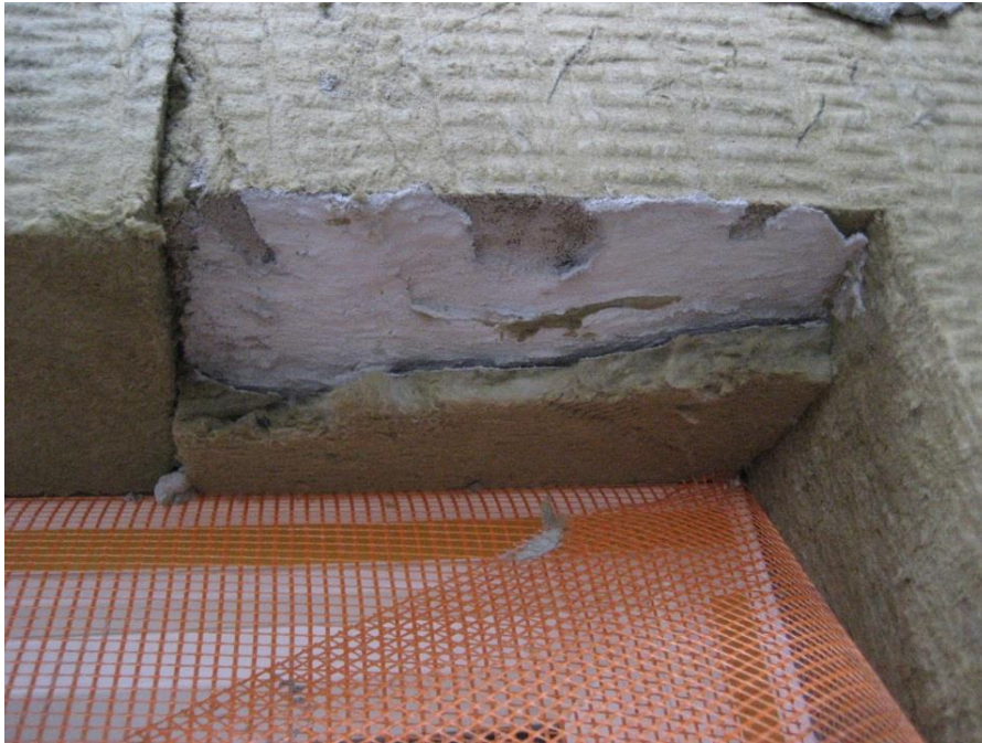
Abbildung 7: Mangelhafte Fenstersturzausbildung (abgelöstes Reststück < 15 cm)
