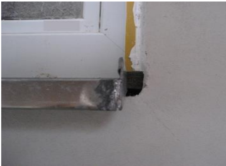
Abbildung 3: Mangelhafter seitlicher Fensterbankanschluss, zu breite Bewegungsfuge
