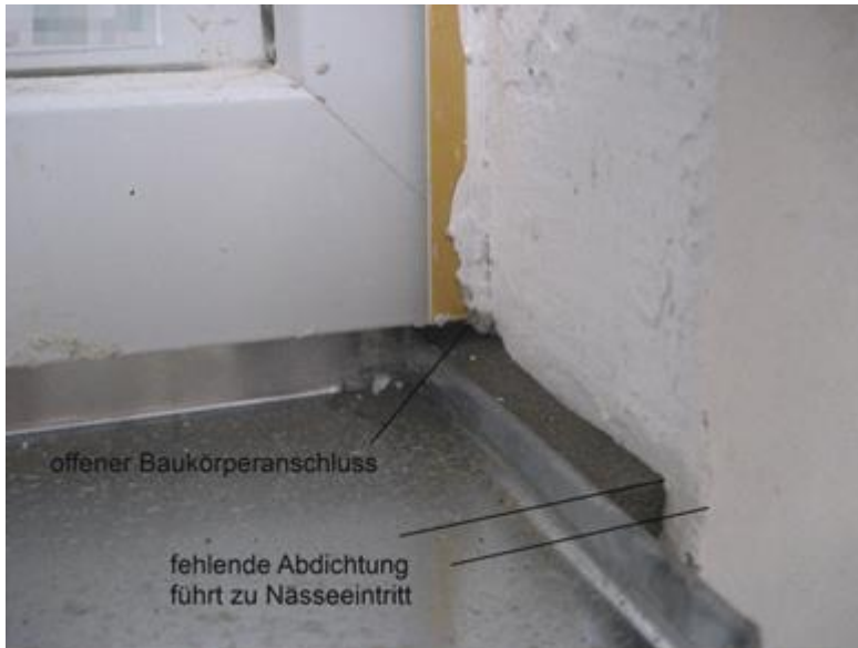
Abbildung 4: Mangelhafter seitlicher Fensterbankanschluss, Dichtband zu kurz
