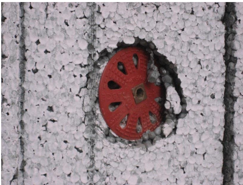
Abbildung 2: Schräg und zu tief versetzter Fassadendübel
