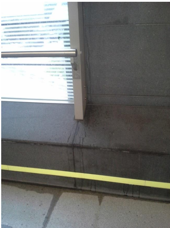
Abbildung 7: Wassereintritt an der Fassade des Bahnsteigs, Foto vom 20. Oktober 2015
