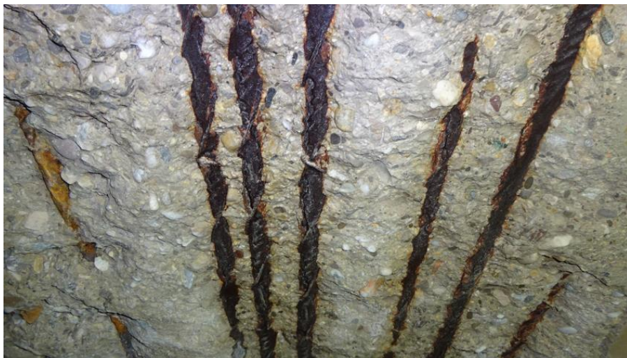
Abbildung 4: Betonschäden in den Pumpenkammern 1 bis 3 nach Freilegung der Bewehrung
