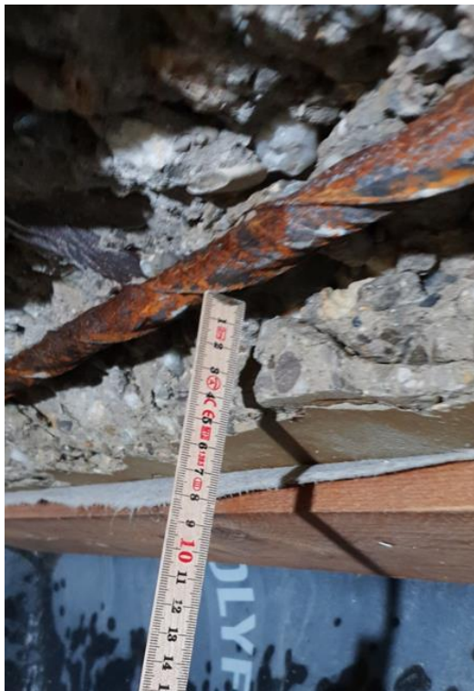
Abbildung 3: Betonschäden in den Pumpenkammern 1 bis 3 nach Freilegung der Bewehrung
