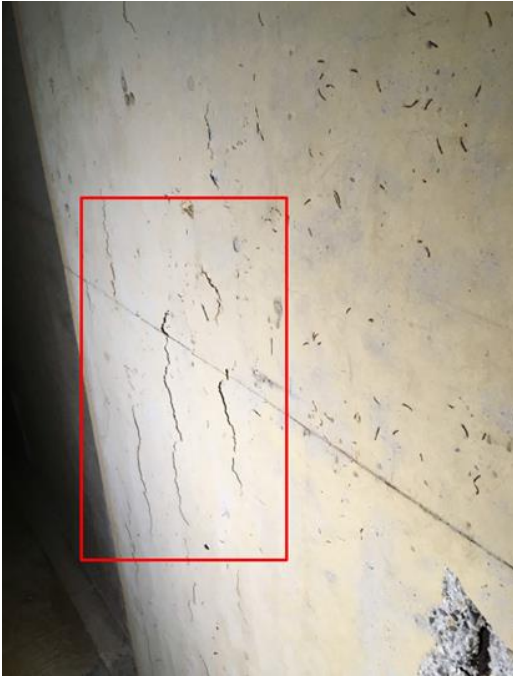
Abbildung 2: Betonschäden - Rissbildungen und Abplatzungen
